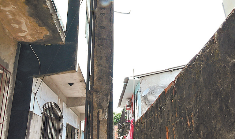
Falta de luz nos postes traz medo para os moradores da travessa Vileta
